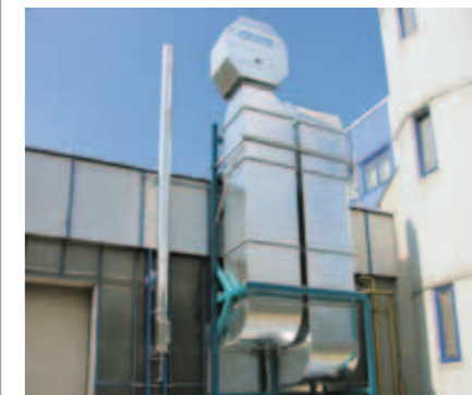
Vzduchotechnika stříkáčcí kabin.
