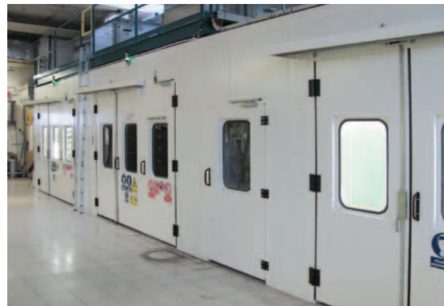
Stříkáčcí kabiny s odsávanou stěnou.
