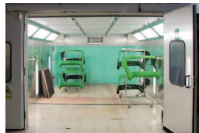
Vnitřek stříkáčcí kabiny s odsávanou stěnou.
