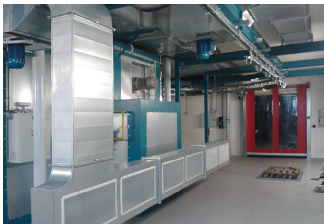
Pracoviště pro nanášení práškových plastů, Xeria spol. s r.o.
