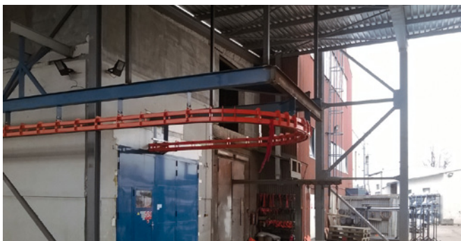
Pracoviště povrchových úprav pro nanášení kapalných nátěrových hmot, Persa a.s.
