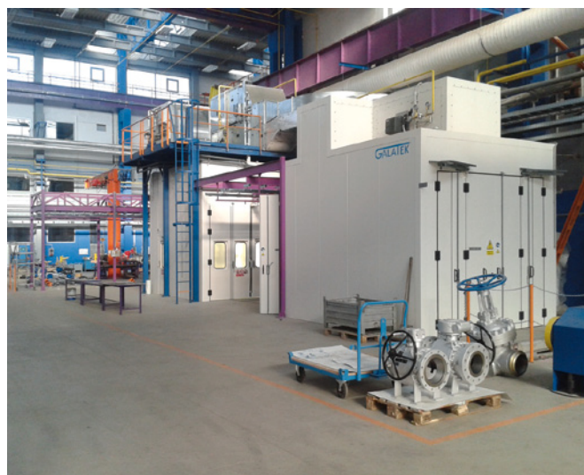
Sušárna velkých armatur
