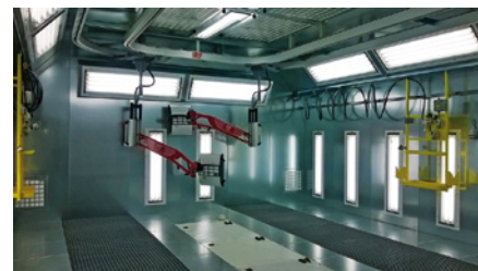
Stříkácí kabina Spotrepair, IR zářiče pro sušení laku - 1
