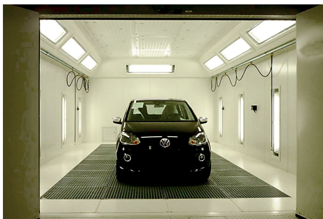
Vnitřní prostor kabiny s podlahovým odsáváním
