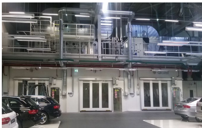
Celkový pohled na spot-repairové kabiny a vzduchotechnickou jednotku
