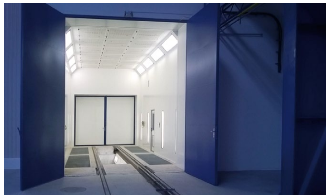
Stříkací kabina s podlahovým odsáváním, ENPAY TRANSFORMER COMPONENTS s.r.o., Levice
