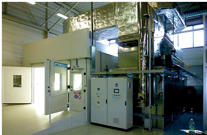
Celkový pohled na stříkací kabínu s nájezdovou rampou a vzduchotechnickou jednotku
