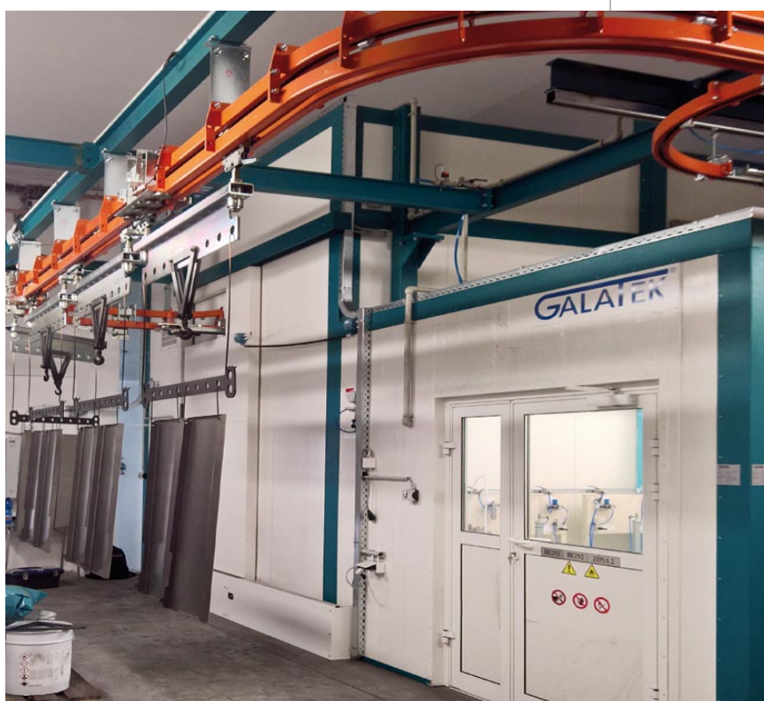
Firma HAAS + SOHN Rukov, s.r.o., Jiřetín pod Jedlovou - Lakovací linka na krbová kamna
