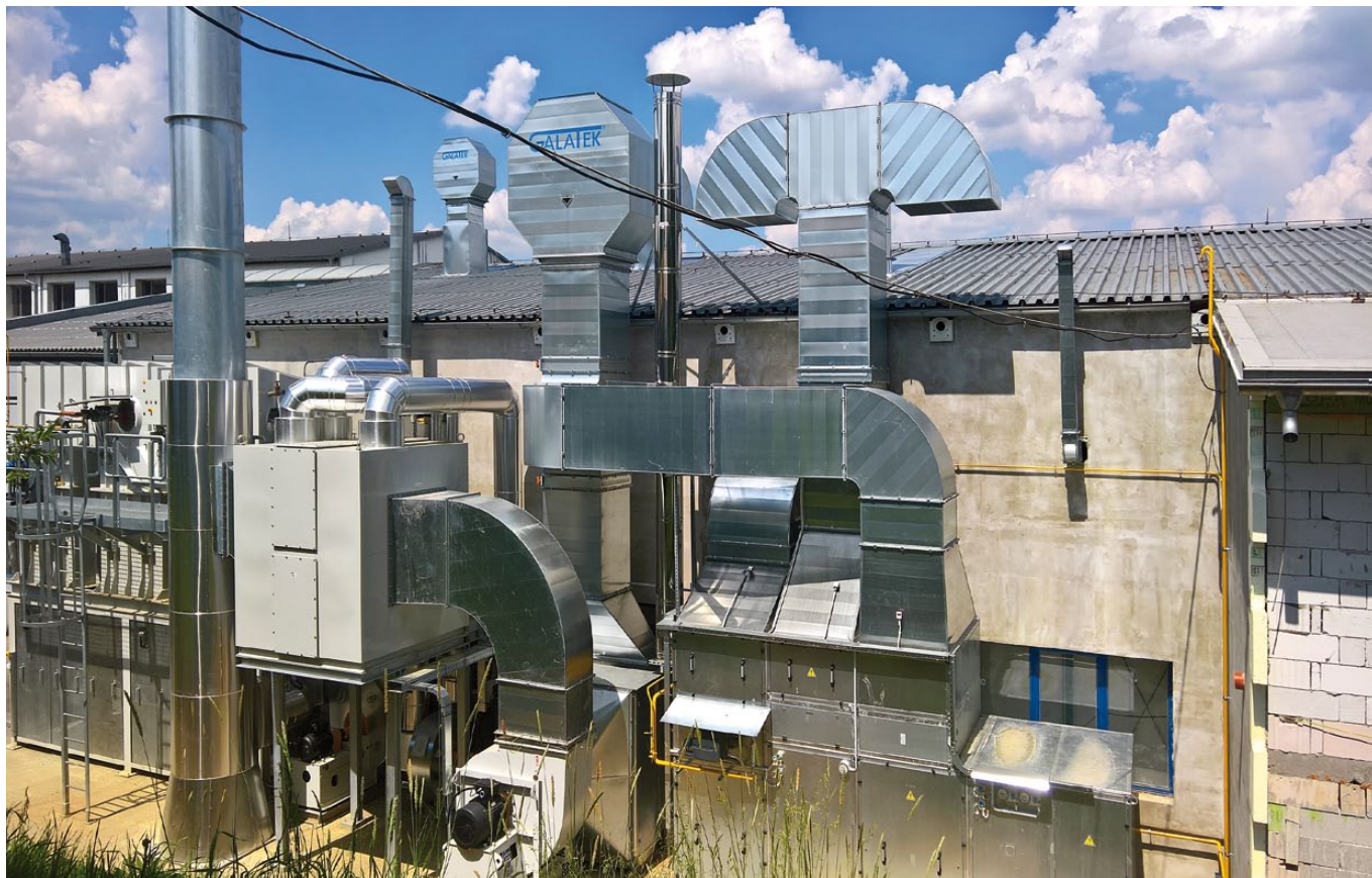
Firma HAAS + SOHN Rukov, s.r.o., Jiřetín pod Jedlovou - spalovna, vzduchotechnické potrubí
