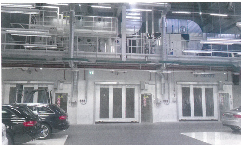
Obr. 1 – Celkový pohled na spot-repairové kabiny a vzduchotechnickou jednotku
